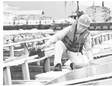
陈思伟在福建宁德市三都澳海域检查海上光伏设施。
