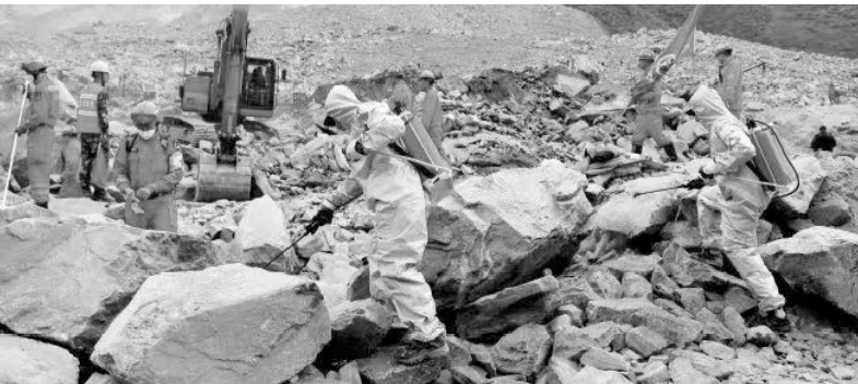
2017年6月,救援人员在新磨村山体滑坡现场忙碌。
